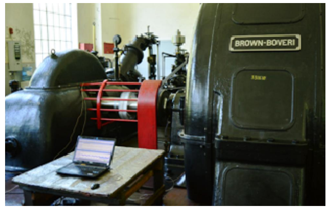
Instalare pe arbore, transmitere wireless a semnalelor de cuplu si turatie, calculul puterii mecanice la intrarea in generatorul electric, analiza detaliata in domeniile timp si frecventa a regimurilor stationare si tranzitorii
