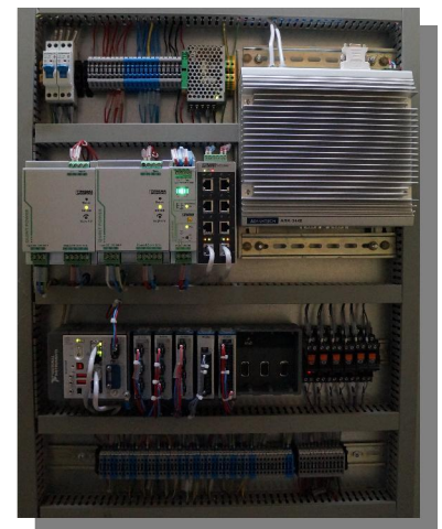
Contrapanou complet echipat cu schemele de monitorizare in timp real si de diagnoza continua
